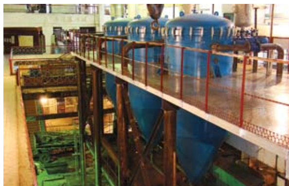
Рис. 1. Станция фильтрования сока I сатурации на сахарном заводе производительностью 3000 тонн свеклы в сутки Площадь фильтрования каждого фильтра 109 м 2 , один находится в резерве.
